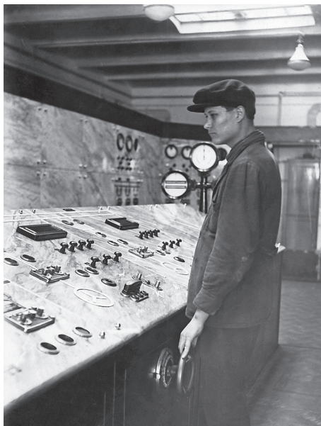
Щит управления Самарской ГРЭС
